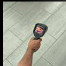
检查地板采暖，发现裂缝
