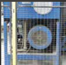
检查电力发动机的运转状态
