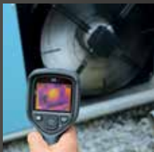
检测暖通空调系统异常
