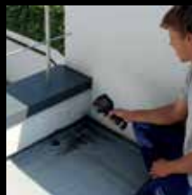
发现屋顶渗漏
